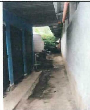
Foto 4: Se necesita una base para tinaco, debido a que se encuentra en mal estado.
