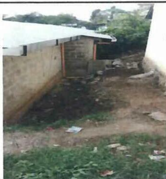
Foto 3: Se necesita realizar un muro perimetral para evitar que la tierra del vecino cause daños a la infraestructura del establecimiento.
