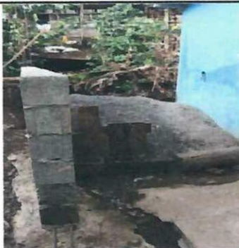
Foto 1: Se necesita muro perimetral y puerta metálica en la entrada, debido a que personas ajenas al establecimiento ingresan a darle mal uso a los sanitarios y se roban el agua de los tinacos.
